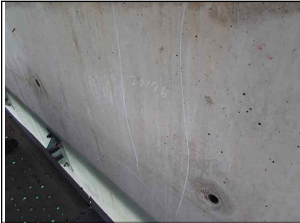
교각 P1 코핑 균열(0.3mm미만)
