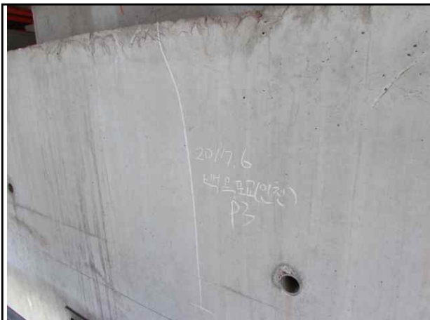
교각 P2 코핑 균열(0.3mm미만)
