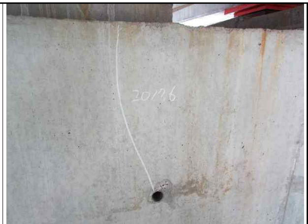
교각 P2 코핑 균열(0.3mm미만)
