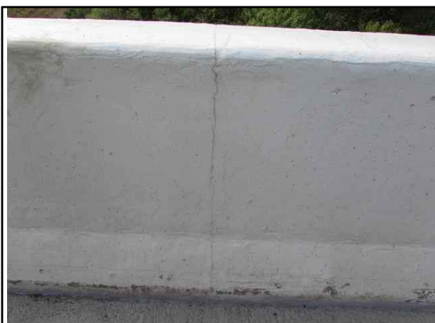
방호벽 S4 균열(0.3mm미만)
