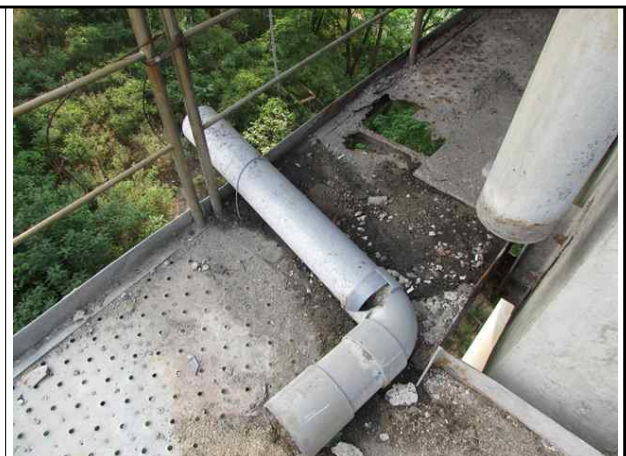
교각 P2 점검시설 부식(추락위험)
