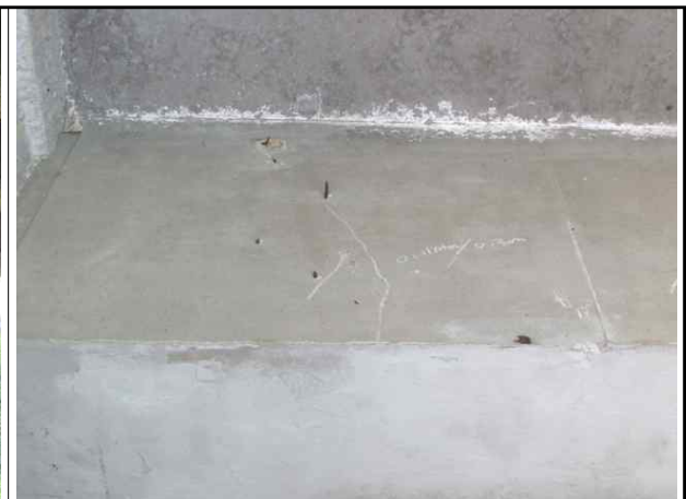
가로보 S4 균열(0.3mm미만)
