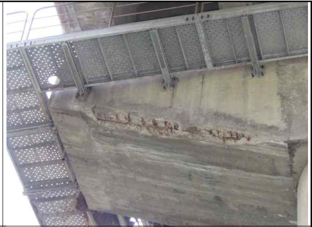
교각 P2 코핑 박락 및 철근노출
